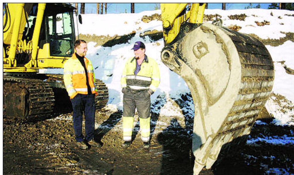
Trots omfattande markarbeten i blöt terräng har Skanska utfört arbetet på rekordtid. På bilden Robert Olsson och Janne Rödin.
