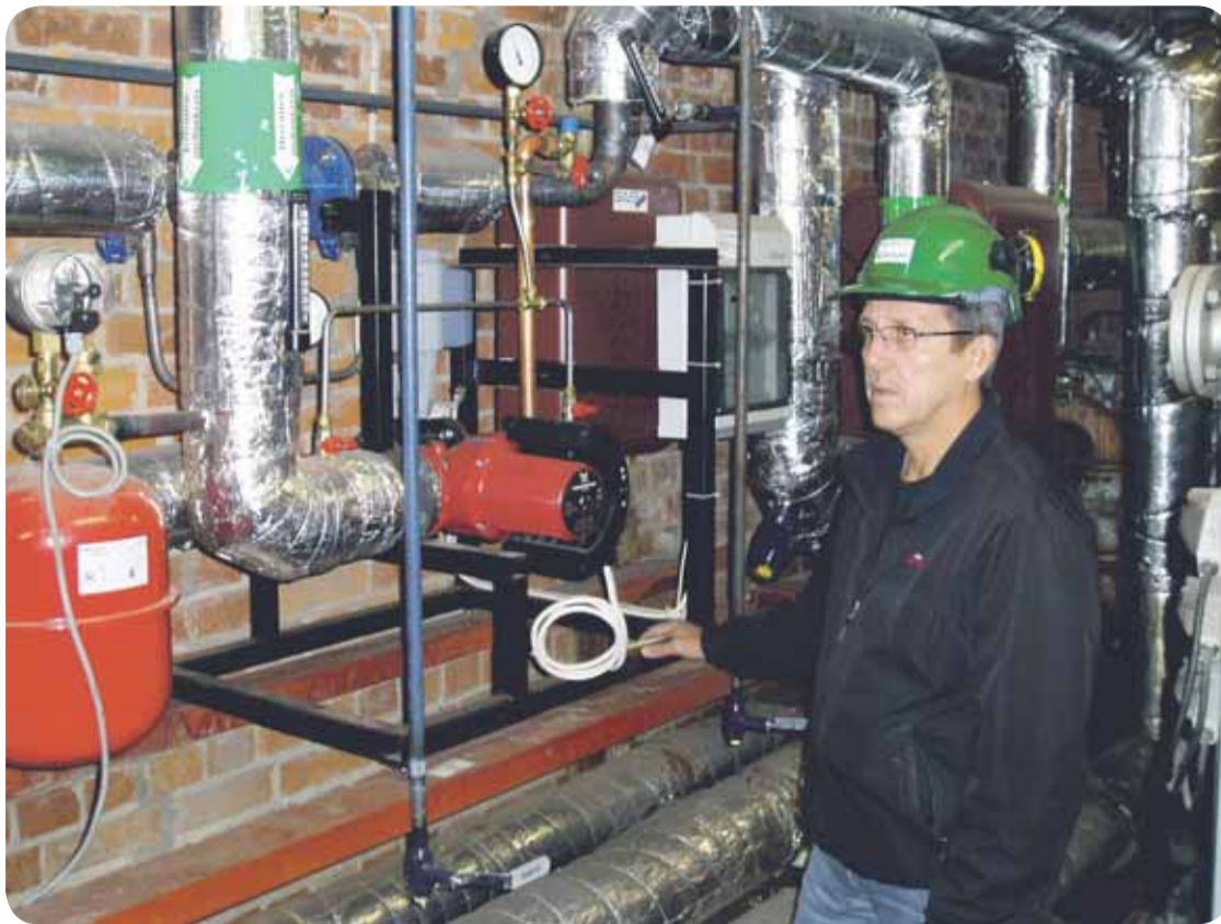
Den nya anläggningen för att värma upp Ovakos eldningsolja är enkel, driftsäker och miljövänlig, säger Kurt Westlund underhållsingenjör.
