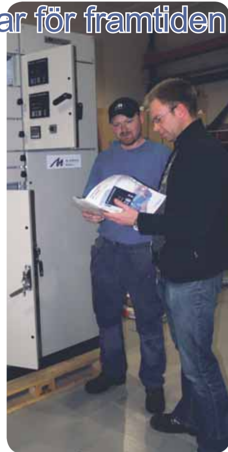
Midroc Electro kan erbjuda nyanställda en utmanande och utvecklande yrkeskarriär. På bilden montör Jimmy Lejdsten i samtal med arbetsledare Mattias Johansson.
